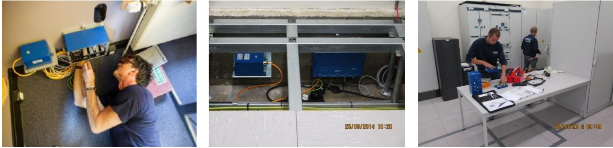
Figuur 3.13 Installatie van de gebouwsensoren.
